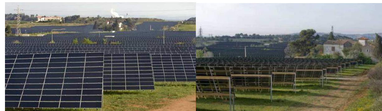
Photo 44 : Illustrations montrant le développement de la végétation sous les panneaux photovoltaïques
